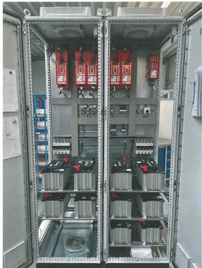
Unter der Typenbezeichnung KTS bietet Koch anschlussfertige Komplettsysteme in Schaltschränken an.
